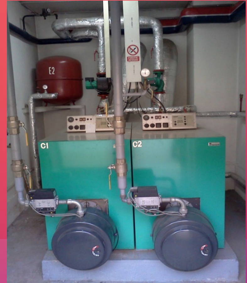
Instalație încălzire apă
